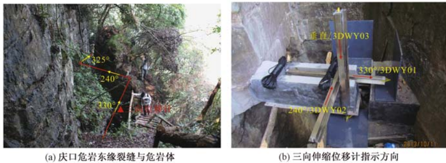
图 3 重庆羊角庆口危岩三向伸缩位移监测
