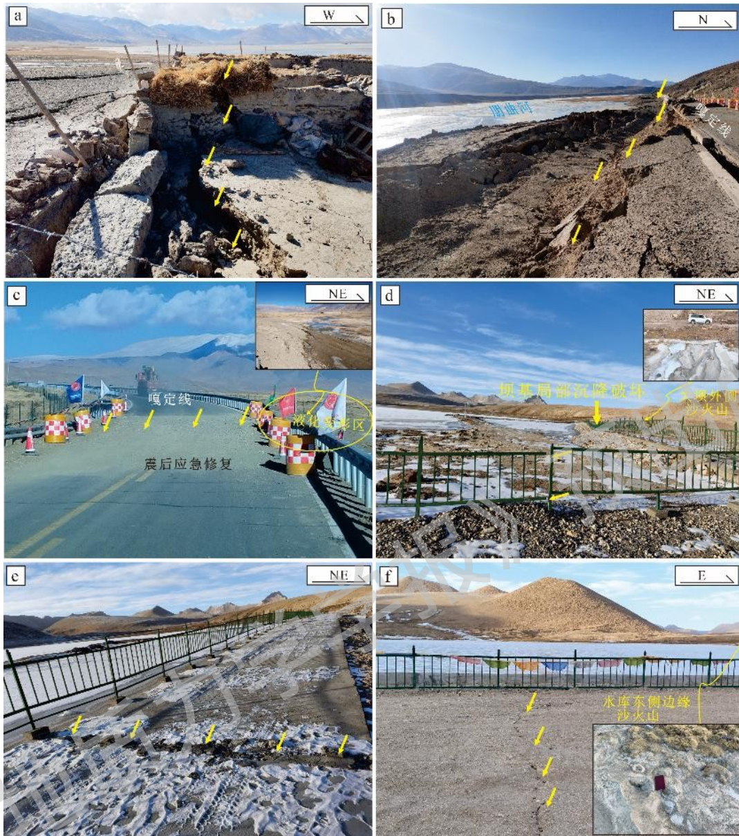
a—登么错湖东岸地表塌陷破坏建筑物；b—液化变形造成朋曲河北岸嘎定线路基大面积破坏；c—液化变形破坏跨登么错河谷的交通主干道；d—尼辖错水库坝基差异性沉降；e—尼辖错水库坝基破裂；f—长所拉昂水库坝基破裂
